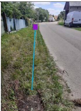
Parcours GC depuis la chambre FT_50027_185 vers future chambre L2T FREE PCH_BCY50_001_FM0004.
